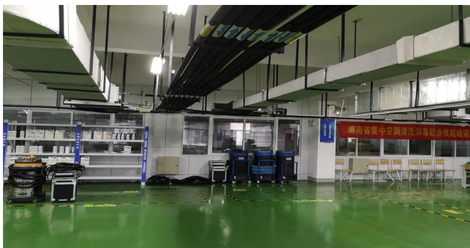
图 5-5 现代制冷空调产教融合实训基地现场
